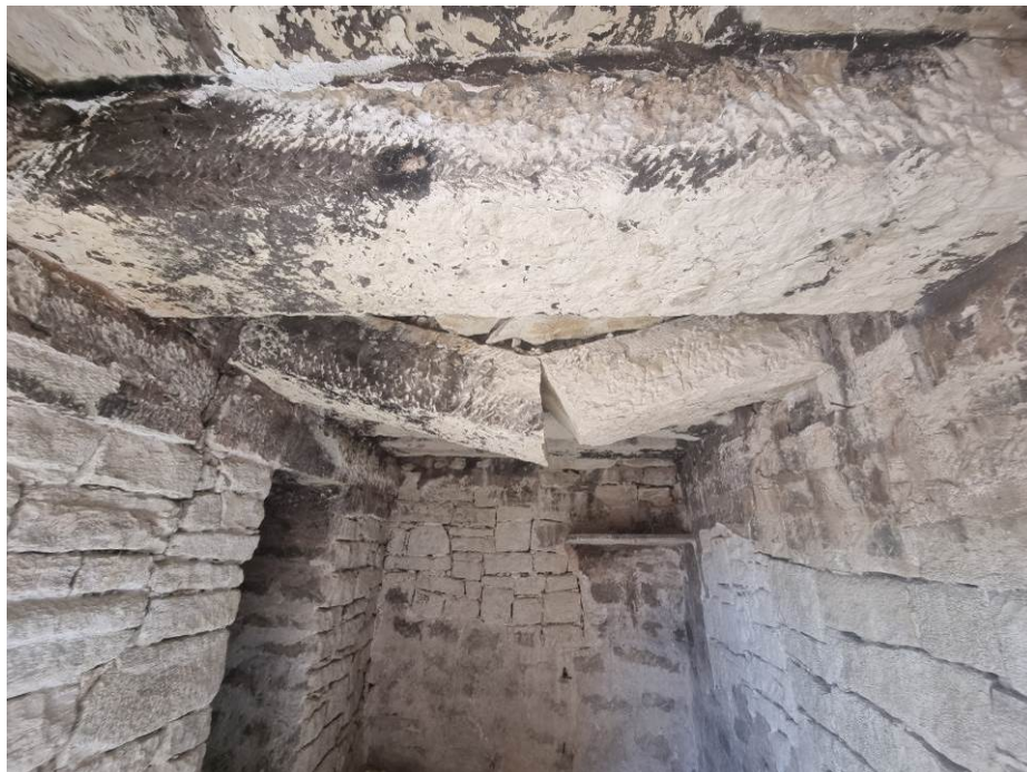
Fig. 17: Detalle de la viga a punto de colapsar de la cámara nº 2. Marzo 2023.
