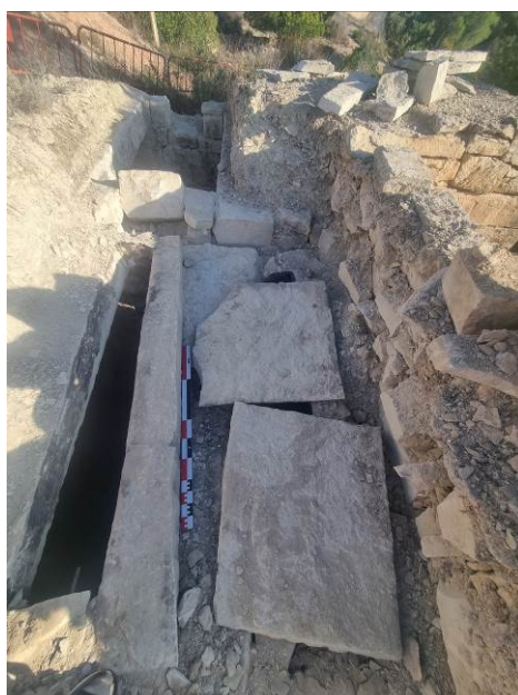
Fig. 32: Otra vista de la techumbre del refugio tras la extracción de su cubierta de tierras y ripio, donde se observan las losas de piedra que se colocaban sobre las vigas, en este caso fisuradas. 13 octubre 2023
