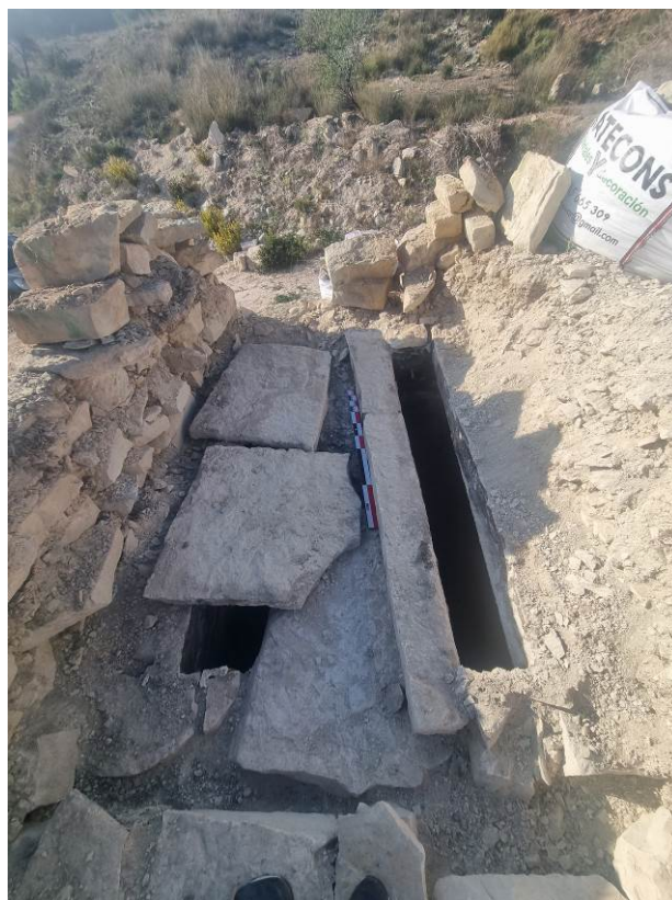
Fig. 31: Vista de la techumbre del refugio tras la extracción de su cubierta de tierras y ripio, donde se observan las losas de piedra que se colocaban sobre las vigas, en este caso fisuradas, con peligro de colapso en la cámara 1. 13 octubre 2023.
