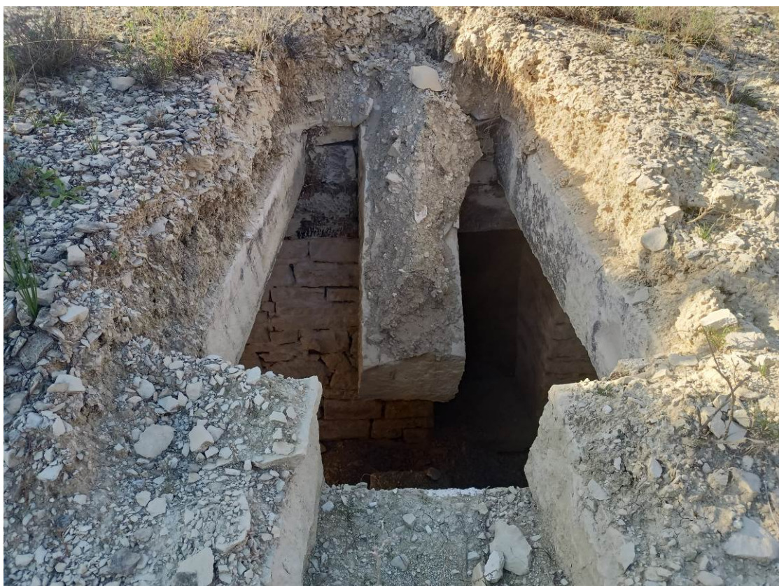
Fig. 23: Vista de la techumbre del Refugio nº 6 de la Canyadeta de Monòver, una vez colapsada. Càmera nº 2. Octubre 2023.
