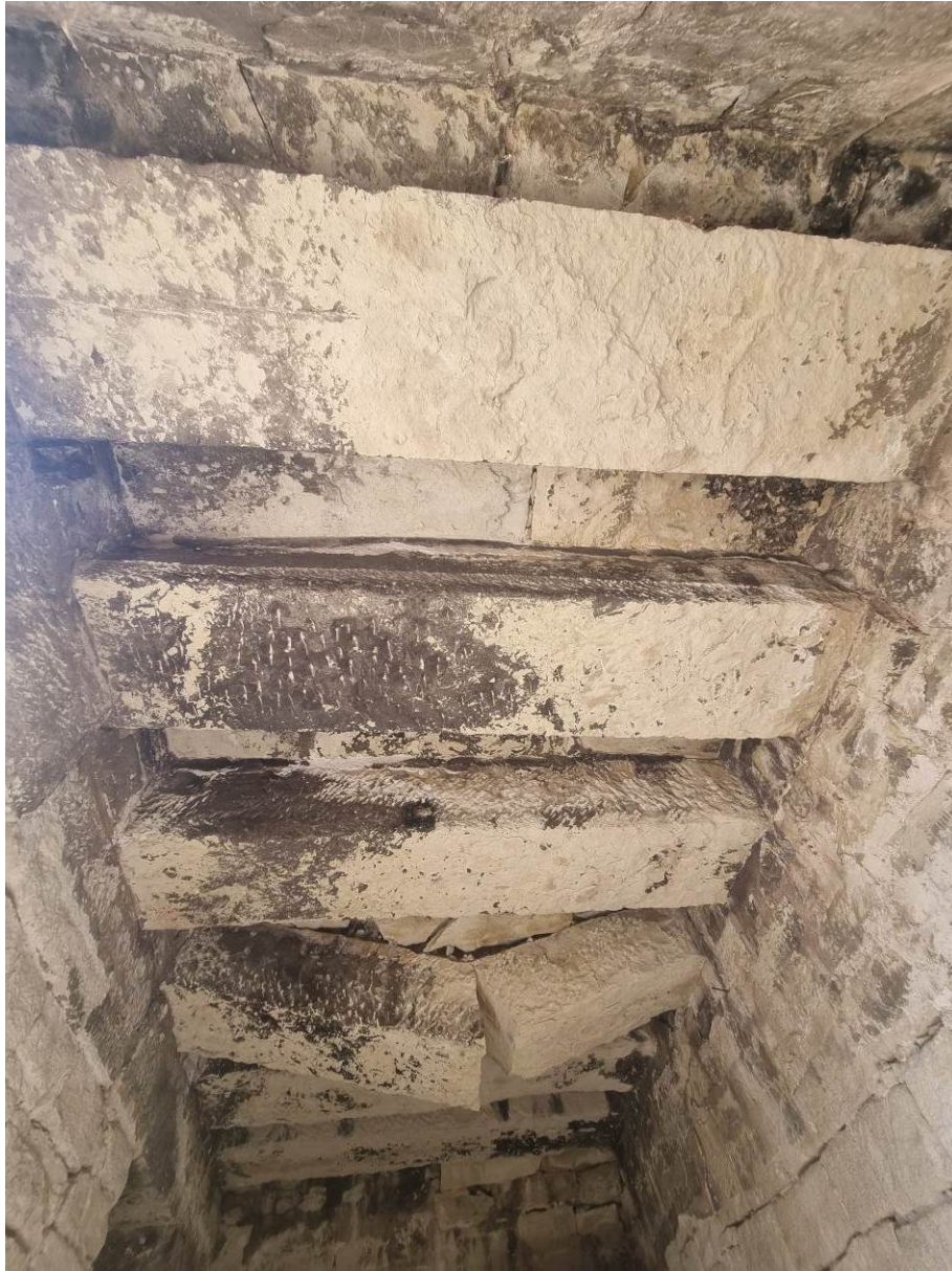
Fig. 20: Vista de las vigas que soportan la techumbre del Refugio nº 6 de la Canyadeta de Monòver. Cámara nº 2. Se observa la viga fisurada a punto de colapsar. Marzo 2023.
