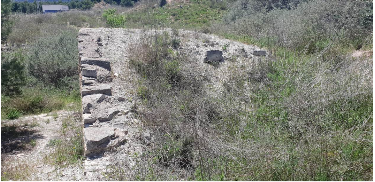
Fig. 8: Parte superior exterior del refugio, donde se veía viga que sobresalía, y que empezaba a fisurarse. Mayo 2021.
