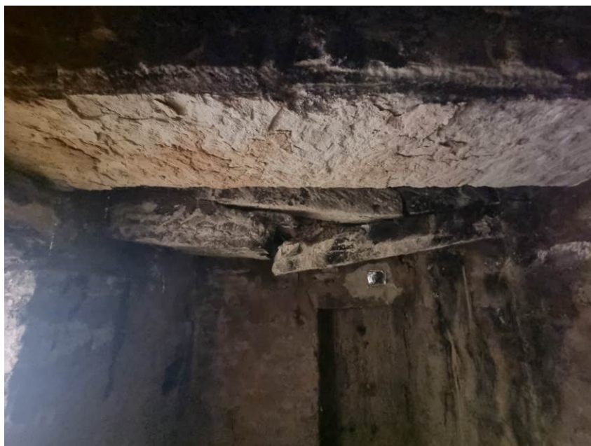
Fig. 14: Interior del refugio de cantero nº 6 de la Canyadeta en Monòver. Cámara 1, la más antigua, con su viga a punto de colapsar. Marzo 2023.
