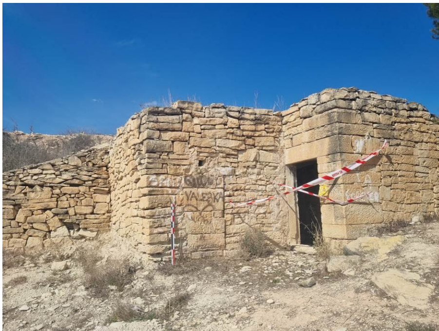
Fig. 70: Estado previo del refugio con varios graffitis antes de iniciar la intervención.
