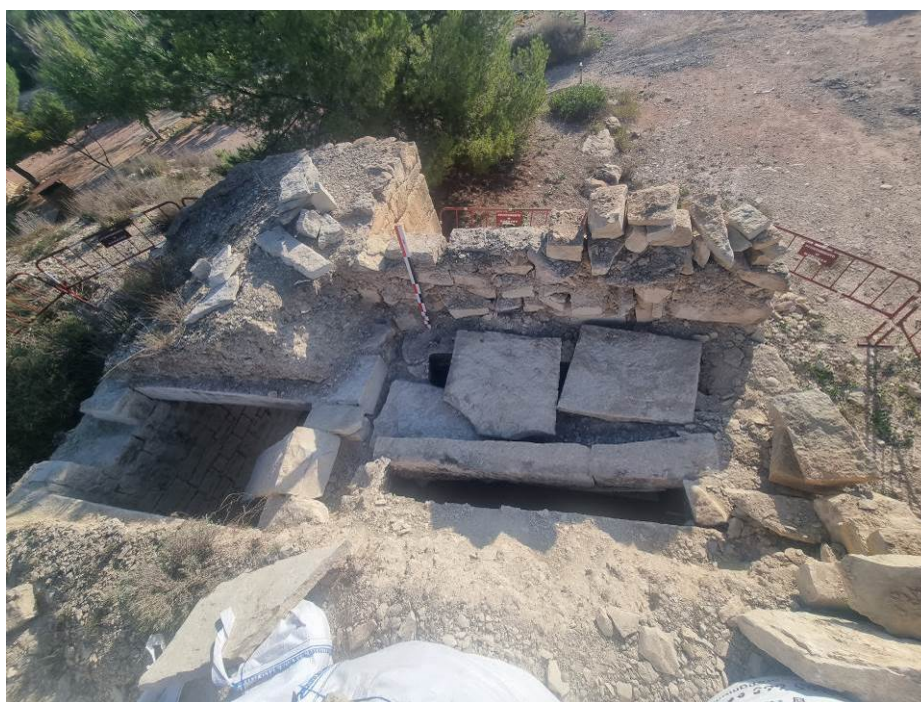
Fig. 30: Vista de la techumbre del refugio tras la extracción de su cubierta de tierras y ripio, donde se observan las losas de piedra que se colocaban sobre las vigas, en este caso fisuradas, con peligro de colapso en la cámara 1, y ya derruida la viga ubicada sobre la cámara 2. 13 octubre 2023.
