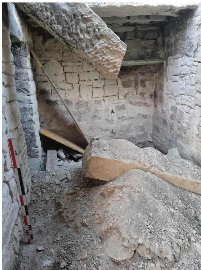
Fig. 21: Vista de la viga del Refugio nº 6 de la Canyadeta de Monòver, una vez colapsada su viga central. Cámara nº 2. Octubre 2023.
