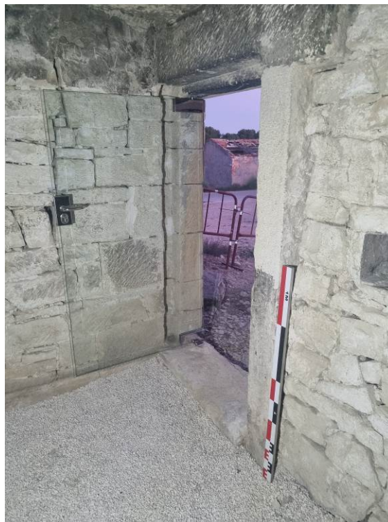
Fig. 86: Otra vista de la nueva puerta de vidrio instalada para acceder al refugio.
