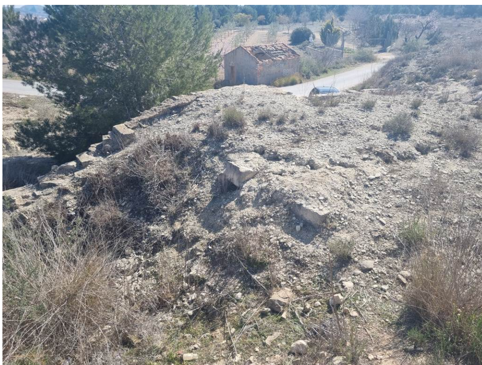
Fig. 13: Parte superior de coronación del refugio de cantero nº 6 de la Canyadeta en Monòver. Se observaba la viga levantada que estaba a punto de colapsar. Marzo 2023.
