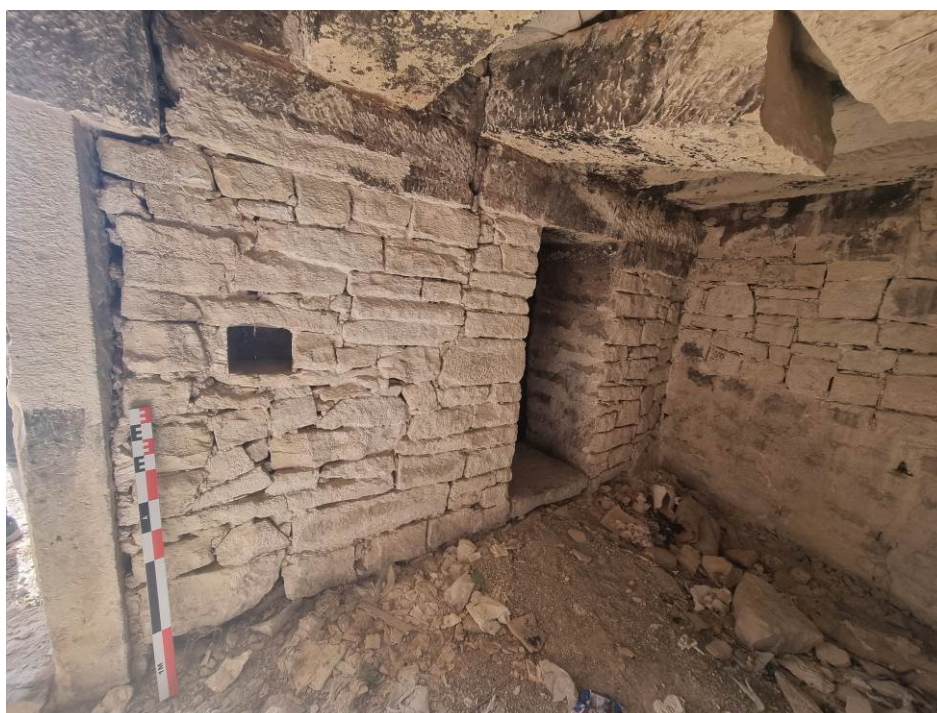
Fig. 19: Interior del refugio de cantero nº 6 de la Canyadeta en Monòver. Se observa la viga a punto de colapsar de la cámara nº 2, otra hornacina ubicada en la pared sur de la sala, y el acceso adintelado a la cámara nº 1. Marzo 2023.
