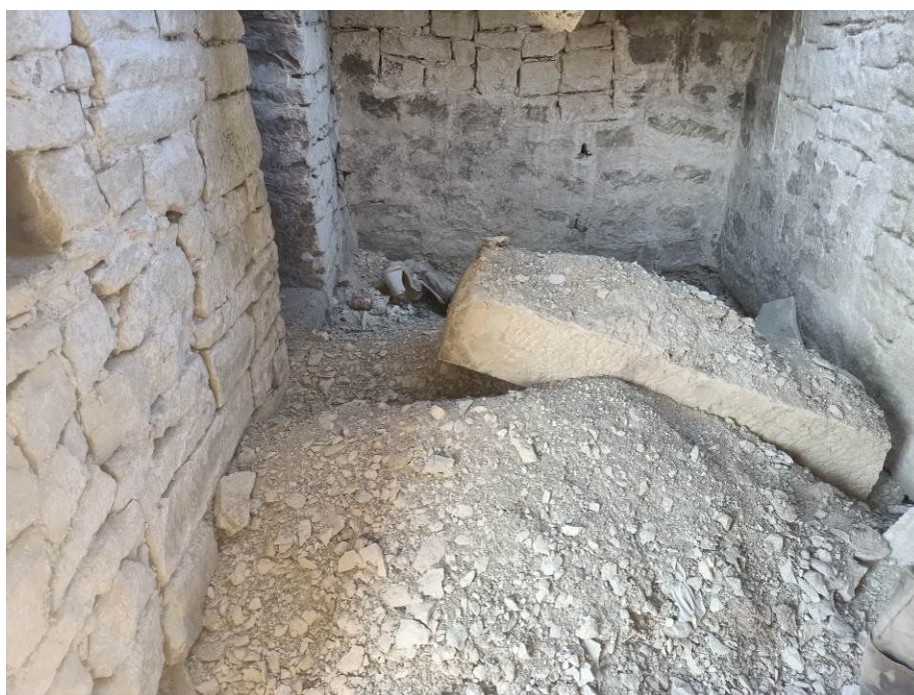
Fig. 22: Vista de la viga del Refugio nº 6 de la Canyadeta de Monòver, una vez colapsada. Cámara nº 2. Octubre 2023.
