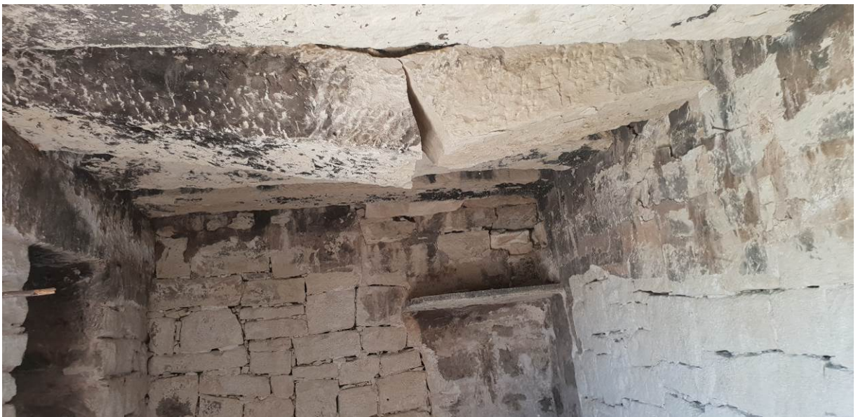
Fig. 9: Interior del refugio, su cámara nº 2, con la viga fisurada. Mayo 2021.
