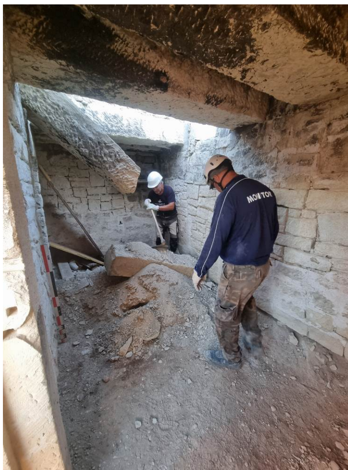
Fig. 24: Vista de la viga del Refugio nº 6 de la Canyadeta de Monòver, una vez colapsada. Cámara nº 2. Inicio limpieza y saneado interior refugio. 10 octubre 2023.
