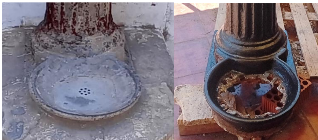
Fig. 11: Rejilla de desagüe.
