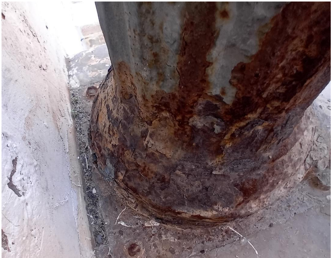
Fig.5: Detalle de la oxidación y pérdida del material.
