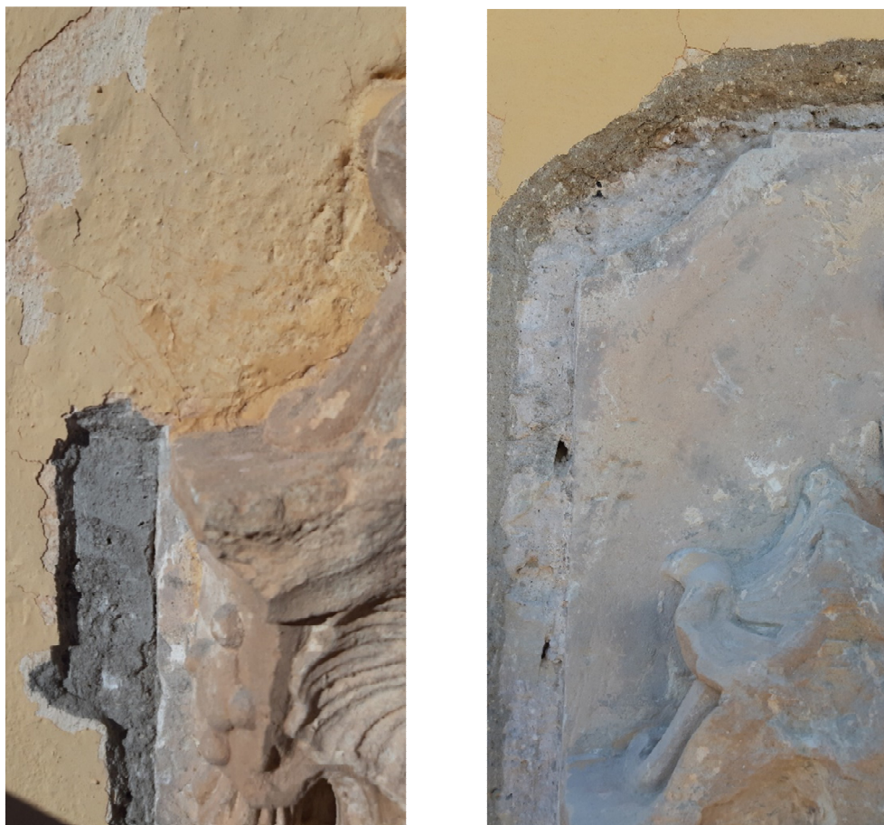
Fig.7 y 8. Detalle del grueso estrato de cemento que había embebido la losa del escudo y detalle de la regata realizada para eliminar el cemento 10 cm alrededor del escudo.
