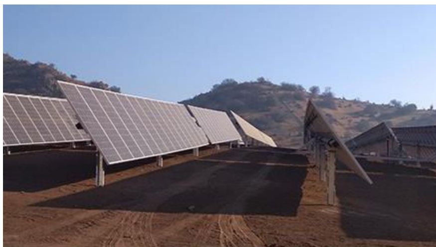
Imagen 77: Ejemplo de seguidores de instalaciones solares fotovoltaicas.
