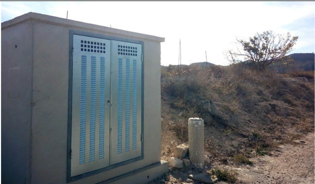
Imagen 53. Imagen de sistema de eléctrico para extracción de agua subterránea.
