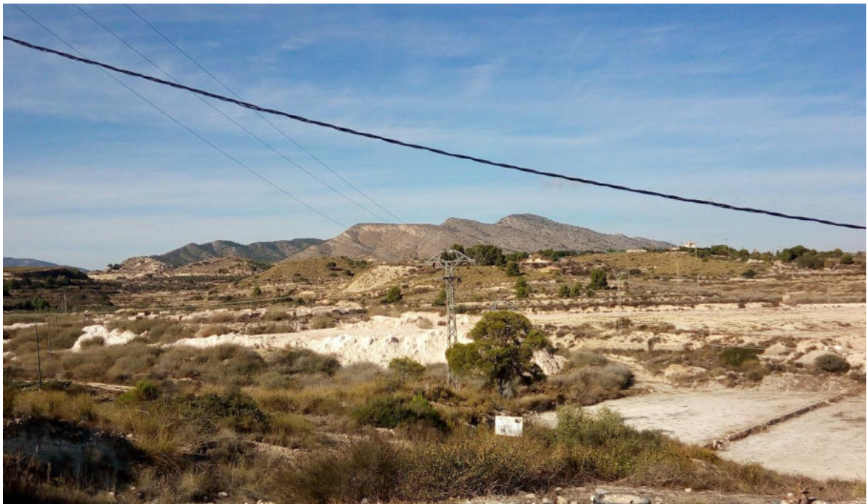
Imagen 56. Apoyos y línea de transporte de energía.
